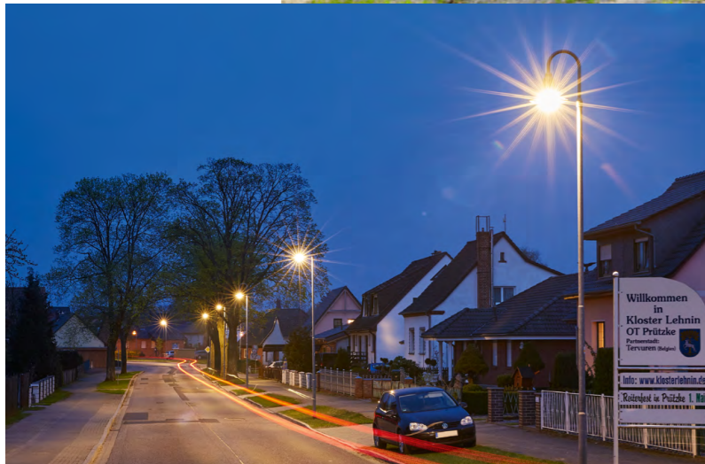
In der Ortsdurchfahrt von Prützke (Gemeinde Kloster Lehnin) sind die Straßenlaternen erneuert worden. Auch hier kommt LED-Technologie zum Einsatz.
